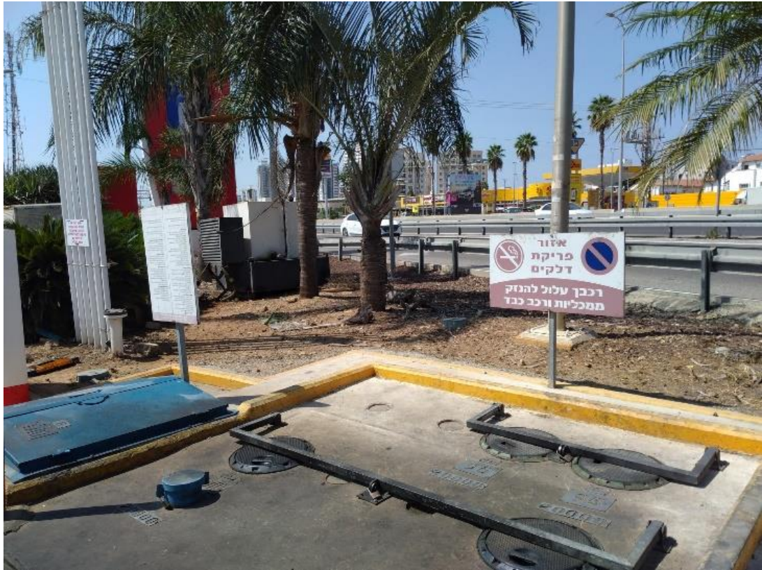
תמונה 2 - גבול כביש 2 - תחנת דלק סוגול. אזור פריקת דלקים (מבט לדרום מערב). ברקע מיכל סולר במאצרה.
