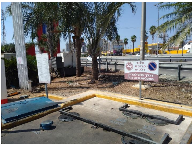
תמונה 58: גבול כביש 2 – תחנת דלק סונול. אזור פריקת דלקים (מבט לדרום מערב)
