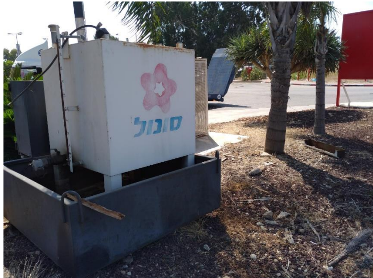
תמונה 55: מיכל הסולר העילי מבט לכיוון מזרח
